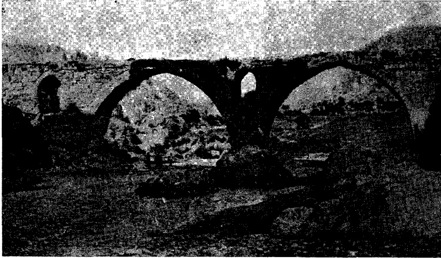
Res. 4 — Havza Yöresi : Kayabaşı (= Tahna) köyü yakınında İstavroz Irmağı üzerindeki harap vaziyette olan "Kurt Köprüsü"ne güneyden bir bakış.
